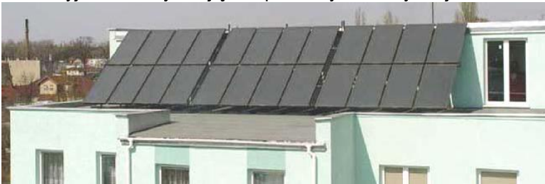
Zgierski TBS z kolektorami słonecznymi fot. www.tbs.zgierz.pl
